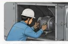
Perbaikan fan / motor rusak
