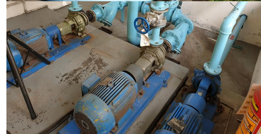
Menara Pendingin dan Pompa pada Sistem Pendingin
